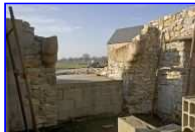
Fig. 6 Porcherie : construction du four à pain avec les corbeaux médiévaux en remploi.
